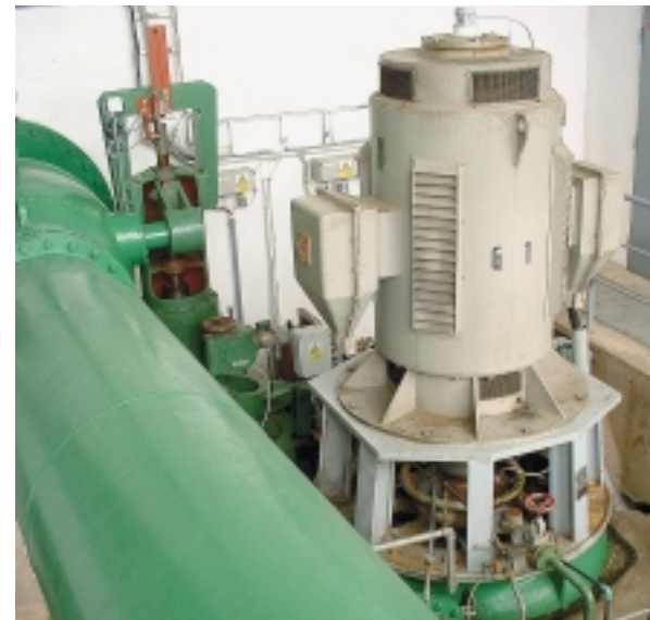
Turbína s generátorem na přivaděči v úpravně pitné vody nahradí škrticí armatury. Foto: EkoWATT
