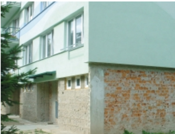
Zateplení štítu je založeno výše než zateplení průčelí, u podlahy 1. patra vzniká tepelný most. Foto: EkoWATT
