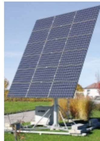
Systém s dvouosým natáčením. Foto: EkoWATT
