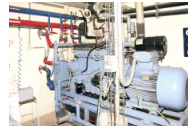
Základem mnoha kogeneračních jednotek je upravený motor z automobilu, na snímku bez protihlukového krytu. Foto: EkoWATT
