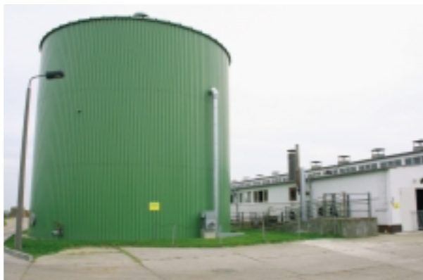
Bioplynová stanice jako součást kravína. Foto: EkoWATT
