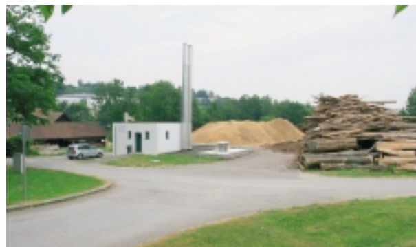
Centrální výtopna na dřevní štěpku (Rakousko). Foto: EkoWATT
