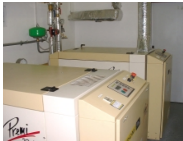
Dvojice menších kogeneračních jednotek pro vytápění a ohřev vody. Foto: EkoWATT
